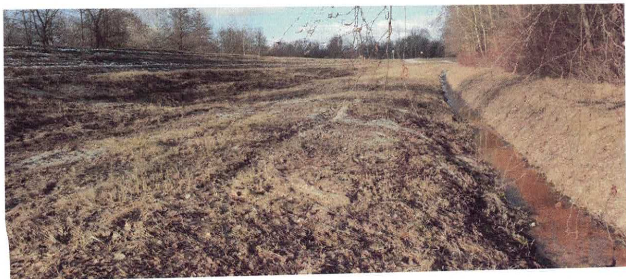
Fot. Widoczne ślady po przebicjach podłoża na stronie odpowietrznej zapory bocznej.
