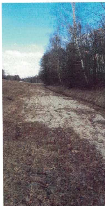
Fot. Widoczne ślady po przebicjach podłoża na stronie odpowietrznej zapory bocznej.
